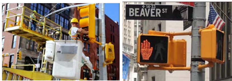
Figura 6c - Maior custo de implantação e manutenção por conta de colunas e grupos focais adicionais Fonte: "Walk This Way - Exclusive Pedestrian Signal Phase Treatments Study - October 2017 - NYC DOT" [1]
