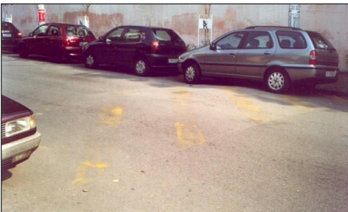
Figura 62 – Exemplo de lombada com pintura desgastada, o que pode gerar colisões ao invés de evitá-las.
